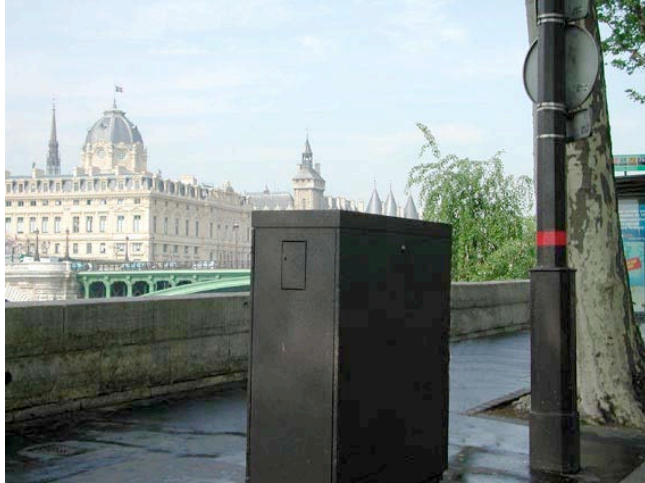
Armoire à feu pour la gestion d'un carrefour. Ici à Paris, dans l'axe de la Conciergerie. Crédit photo : Frédéric Héran.
