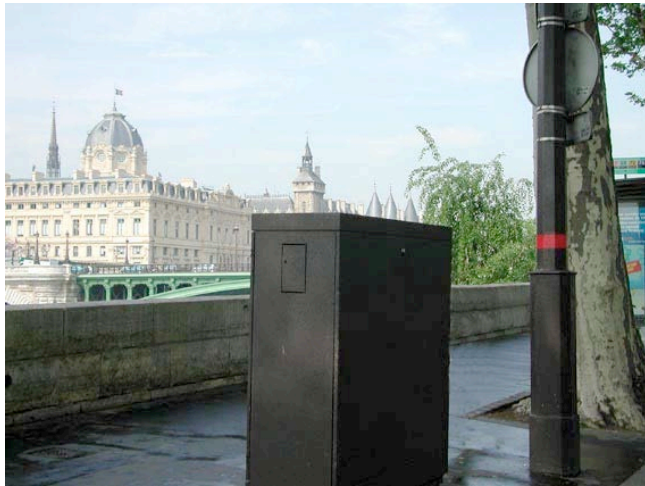
Armoire à feux pour la gestion d'un carrefour. Ici à Paris, dans l'axe de la Conciergerie. Crédit photo : Frédéric Héran.
