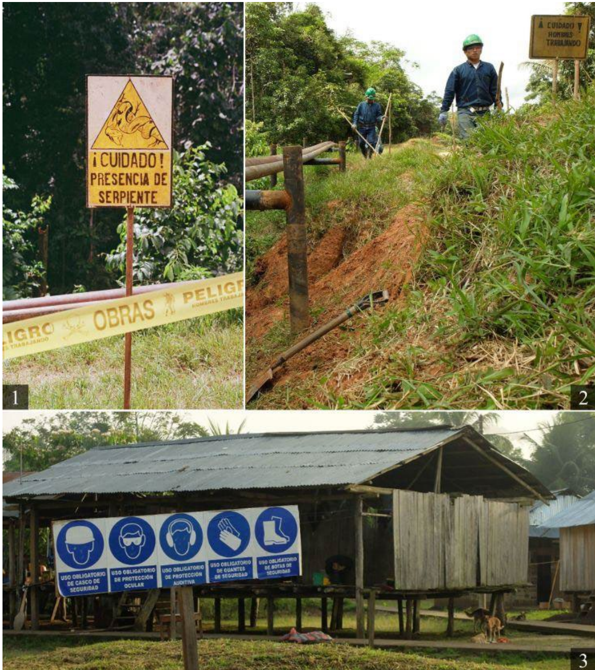
Figure 2 : signalétique sécuritaire sur un front de travail et à Capahuari, 2014
