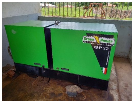
Photo 2 : générateur diesel de la mini-centrale de Keur Ndongo. Source : Emilie Etienne, 2021.
