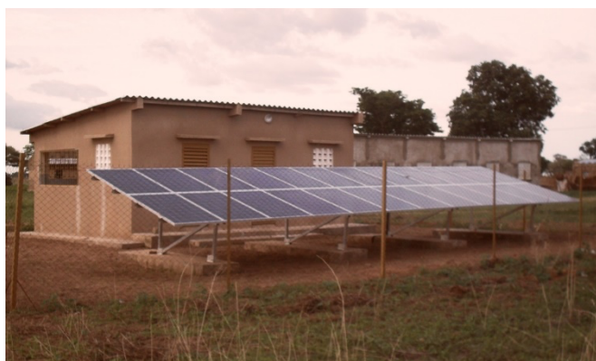
Photo 1 : la centrale de Keur Ndongo avec ses 24 panneaux solaires, son local de stockage de batteries et d'onduleurs. Source : Pierre Robert, 2014.
