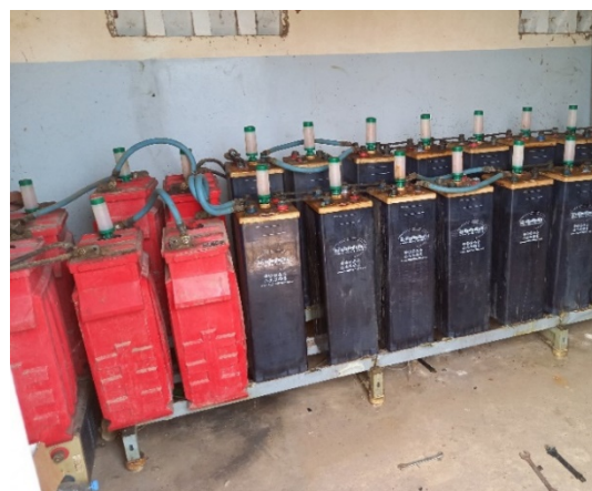
Photo 3 : Batteries de la mini-centrale. Certaines ne fonctionnent plus et ont été débranchées par le conducteur. Source : Emilie Etienne, 2021.
